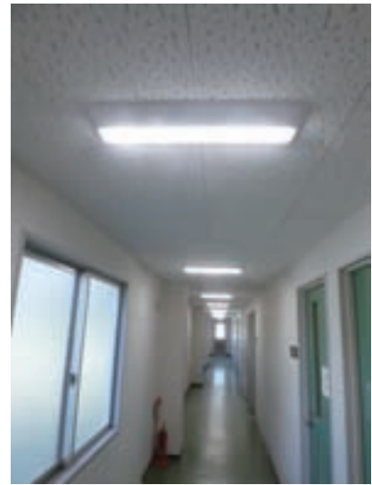
クラブハウスLED照明
