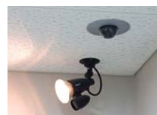
体育館更衣室入口の防犯カメラ
